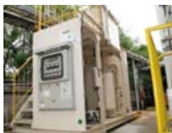
油分系排水処理装置
