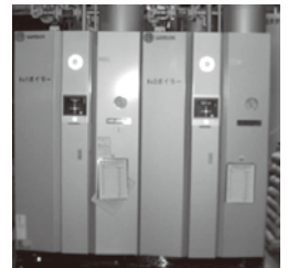
ガス焼き小型ボイラー
