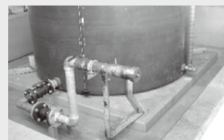
未然防止の対策例 （廃液引取り口からの流出防止）
