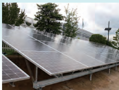
太陽光パネル
